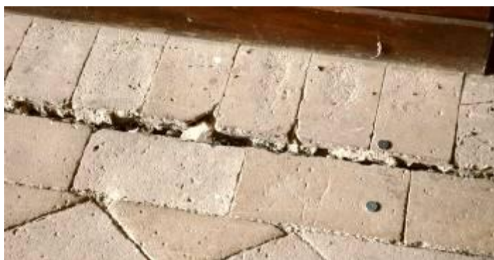
Lesione causata dal cedimento della struttura del pavimento
